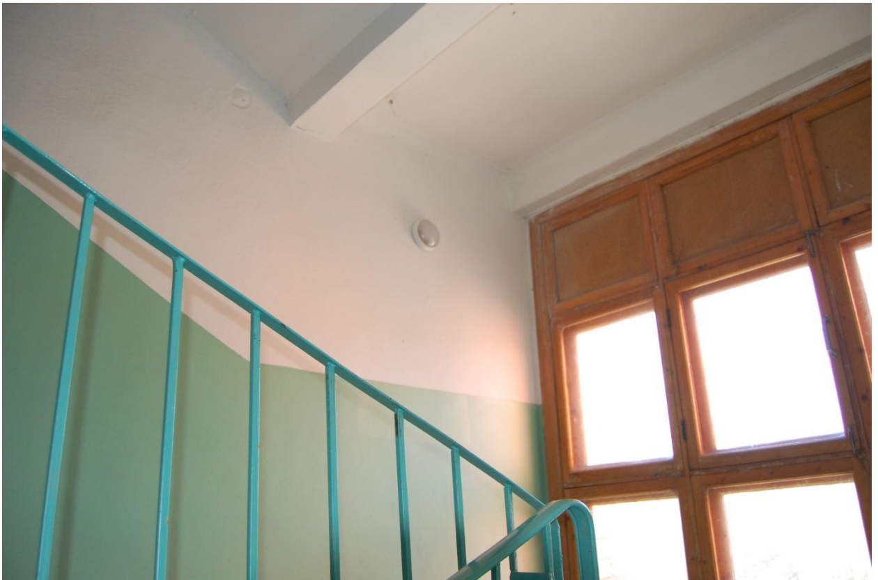
Рисунок 5. Расположение светильника на межэтажной площадке.
